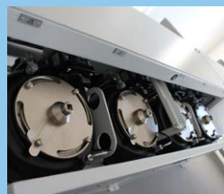
Im oberen Gebäudegeschoß befinden sich die MicroPur®-Filter. Derzeit sind drei Filtergehäuse mit zweimal vier und einmal zwei Filtergehäusen installiert.
