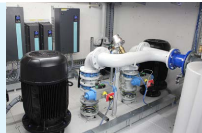
Redundanz herrscht unter anderem bei den großen Versorgungspumpen mit 55 kW.
