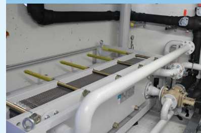
Der Wärmetauscher hält die Temperatur des Schleiföls auf konstant 24 °C.
