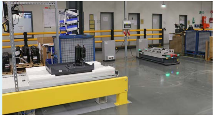
Am Ende der ersten Förderstrecke befindet sich die Übergabestelle ans FTS; rechts im Bild sind zwei Park-/Ladestationen für die FTS zu sehen.
