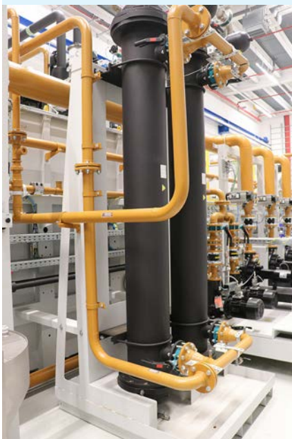
Zwei 3 m hohe Sicherheitswärmetauscher sorgen für eine konstante KSS-Temperatur und vermeiden, dass das zur Kühlung eingesetzte Brunnenwasser kontaminiert werden kann.
