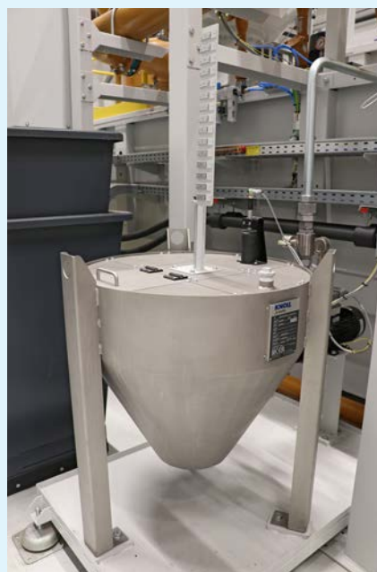
Mit dieser Hebeanlage lassen sich Zusatzstoffe automatisiert zum KSS dosieren.
