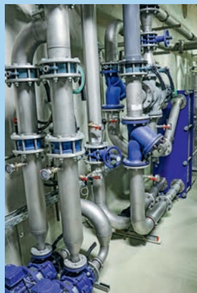
Tubazioni del radiatore/scambiatore di calore a piastre.
