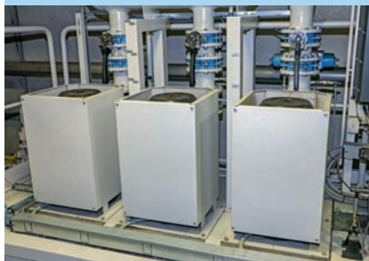
Pompe del liquido puro a controllo di frequenza con calotte di protezione acustica.
