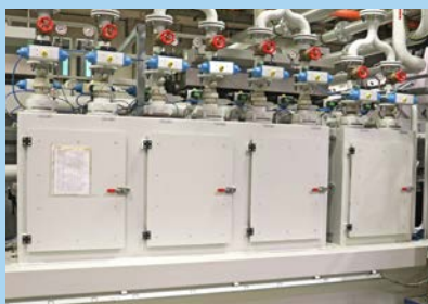
Die wesentliche Filterleistung erbringen vier Hydrozyklone (eingehaust wegen der Aerosolbildung). Darunter liegt der Sammelförderer für das Abschlammgut der Zyklone und darüber die Verrohrung der Zyklone.
