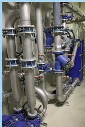
Verrohrung des Kühlers / Plattenwärmetauscher.
