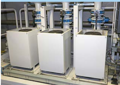
Frequenzgeregelt Reinmedium-pumpen mit Schallschutzhauben.
