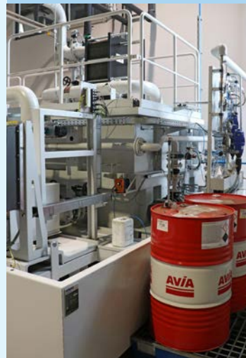
Aus den roten Fässern wird der mineralölfreie, wassermischbare Bantleon-KSS Avilub Metacool ETA automatisch nachdosiert.
