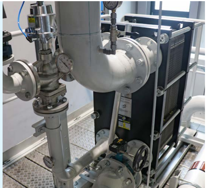
Ein Plattenwärmetauscher hält den KSS auf einer konstanten Temperatur.
